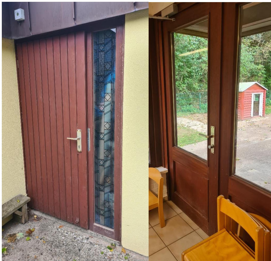
Türen sind kaum isolierend und entsprechen z. T. auch nicht mehr heutigen Sicherheitsrichtlinien.
