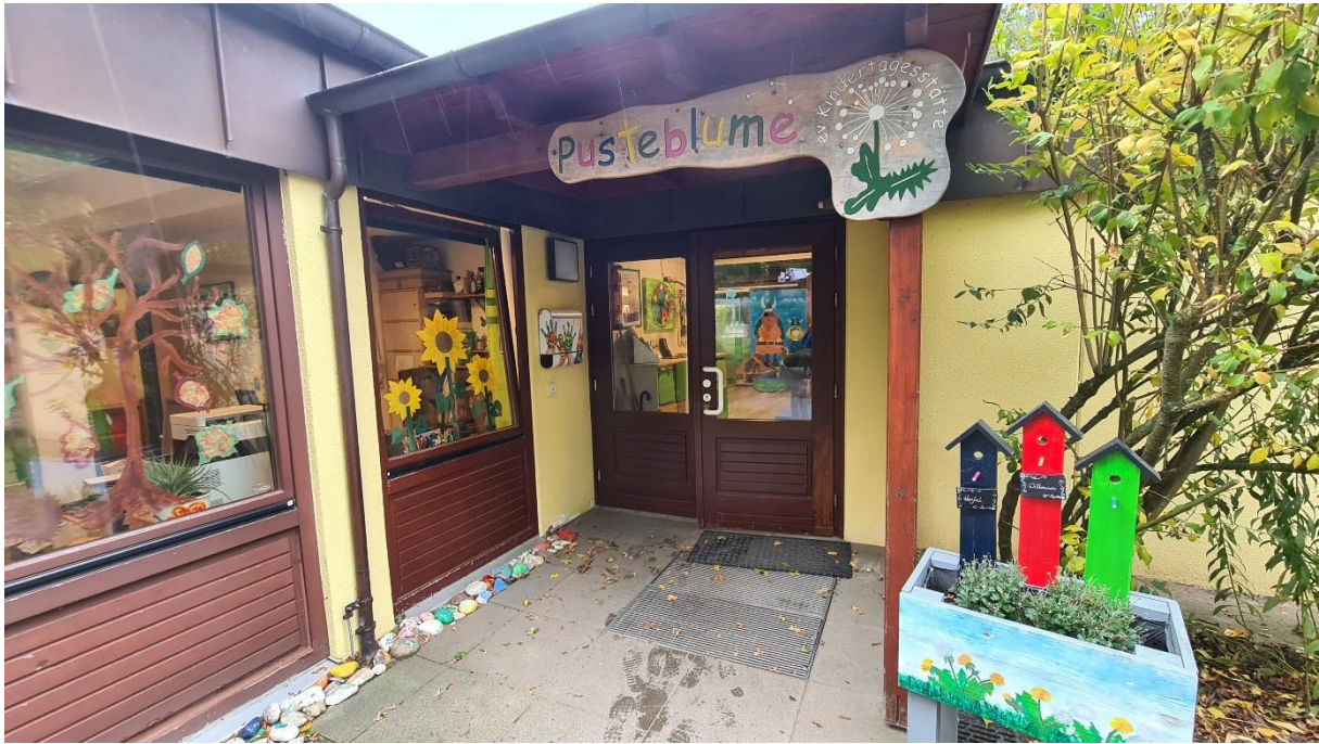
Der Eingangsbereich fällt insbesondere innen durch erhebliche Zugluft auf.
