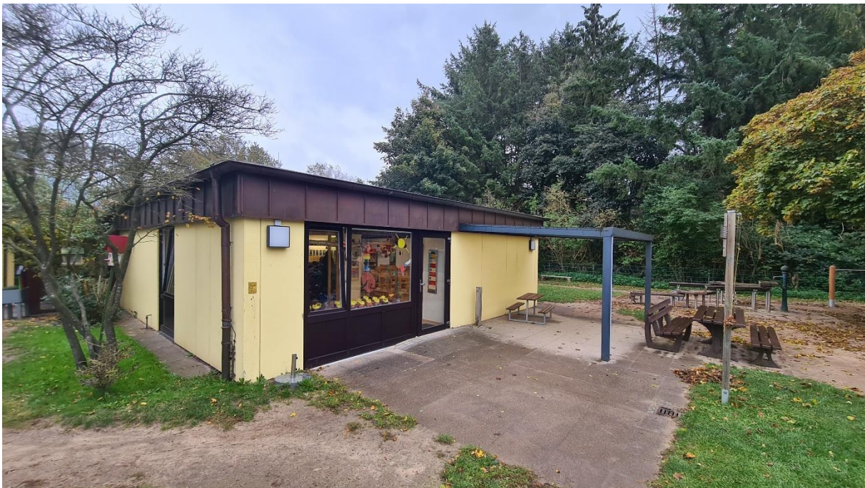
Fensterelemente sind veraltet und insbesondere im Bodenbereich gar nicht Isoliert (dünne Holzwand)
