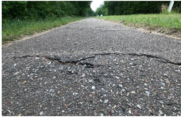
Abbildung 35: Schlechter Zustand des Radwegs
