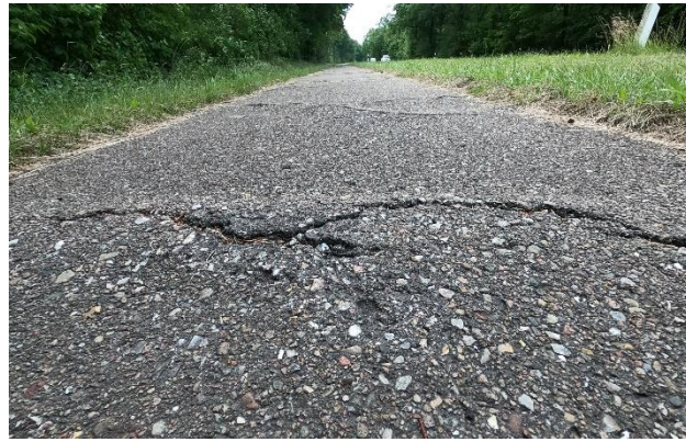
Abbildung 35: Schlechter Zustand des Radwegs
