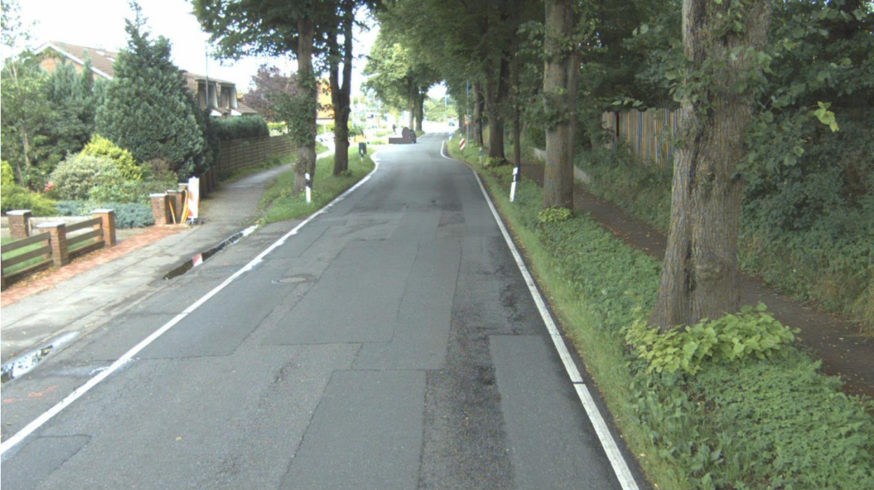
Straße: K75, Abschnitt: 1724010B - 1724002, Station: 540, Lage: R, FS: 1
