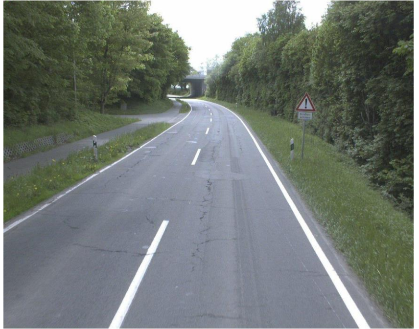
Straße: K0001, Abschnitt: 1524014->1623031, Station: 3582, Lage: R, Arbeitsbereich: SH / KStr 2013 - Rendsburg-Eckernförde, Aufnahme datum: 27.05.2013
