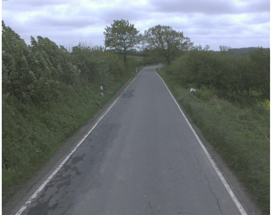
Straße: K0055, Abschnitt: 1524002->1524010, Station: 4568, Lage: R, Arbeitsbereich: SH / KStr 2013 - Rendsburg-Eckernförde, Aufnahmedatum: 22.05.2013
