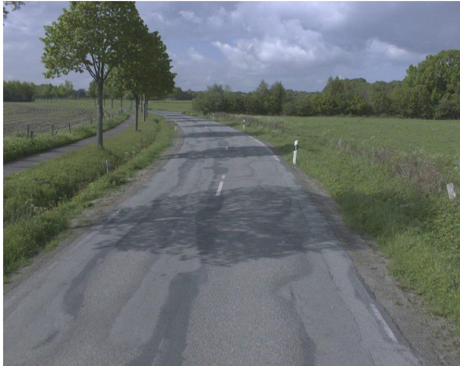
Straße: K0038, Abschnitt: 1923015->1823006, Station: 3922, Lage: R, Arbeitsbereich: SH / KStr 2013 - Rendsburg-Eckernförde, Aufnahme datum: 27.05.2013
