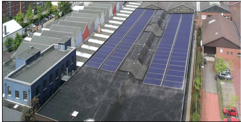
Flachdachfläche eines Gewerbegebäudes in Hamburg mit einer großen PV-Anlage
